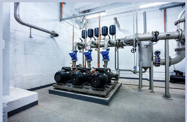
Die Anlage in Tomaszów Mazowiecki nutzt eine Druckerhöhungsanlage vom Typ Hydro MPC von Grundfos für das Prozesswasser. „Ich kaufe diese Grundfos-Anlage für alle meine Projekte in Polen“, erzählt Vertragsmanager Adam Bierut von Cadagua
