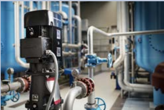
Foto: Die mehrstufige Pumpe CR 95 von Grundfos beim WWSB in Oberwart, Österreich. Die Pumpe war viel kleiner als die älteren Pumpen einer anderen Marke in der Druckerhöhungs-/ Filtrationsanlage. Konnte sie die erforderliche Leistung erbringen?
