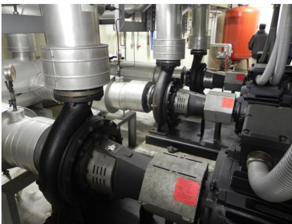
Sekundäre Pumpen in der Kaltwasseranlage für ein großes Stadion
