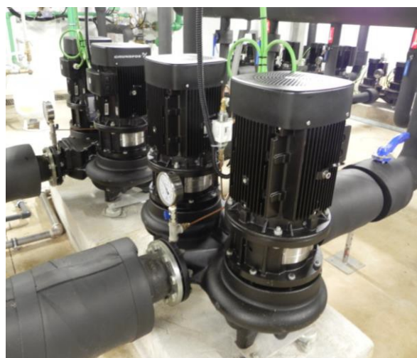
Grundfos TPD Doppelpumpen in einer mittelgroßen Kälteanlage für Wasser
